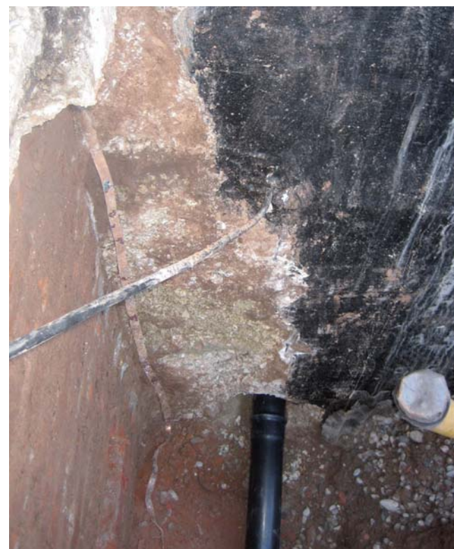
Nicht vollständig ausgeführter Bitumenanstrich: Durch das Fehlen der Feuchtigkeitssperre ist die Gefahr eindringender Feuchtigkeit gegeben.
