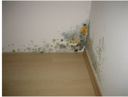
Akuter Befall hinter Schlafzimmerschrank
