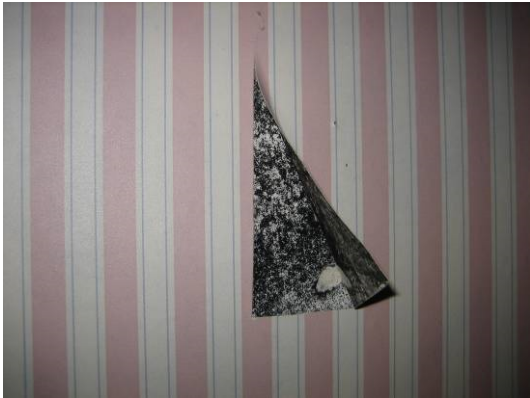
Versteckter Befall hinter Tapete
