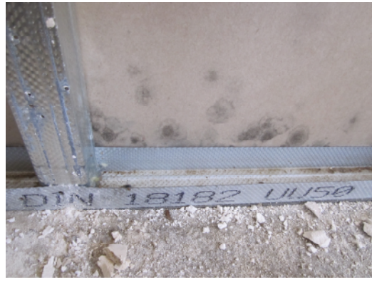
Versteckter Befall in Metallständerwand
