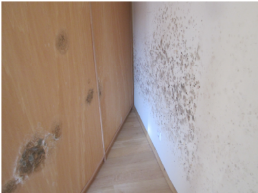
Akuter Befall hinter Schlafzimmerschrank
